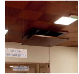
Diffuseur faux plafond
